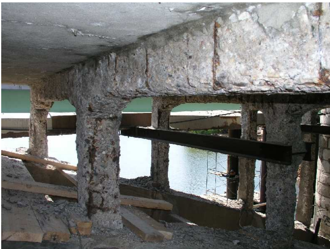
Рисунок Б1 – Пешеходный мост через р. Теза в г. Шуя (Ивановская область). До ремонта
